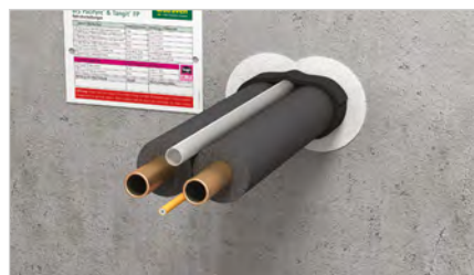
Anschlussleitungen für Kältegeräte (Splitgeräte) mit Kondensatleitung und einem Kabel
