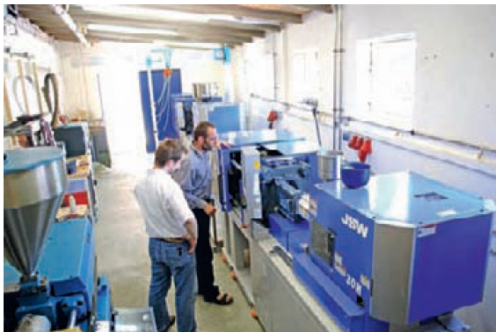
Blick ins Technikum mit den beiden vollelektrischen JSW-Maschinen: eine 1.100-kN-Anlage, die im Dezember 2007 geliefert wurde, und eine 350-kN-Maschine, die seit Februar 2008 bei ATP im Einsatz ist Fotos: ATP
