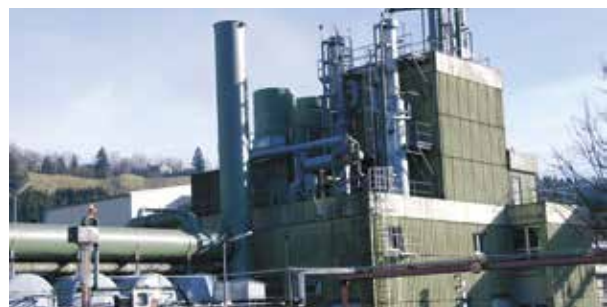
Adsorptionsanlage mit Rektifikationskolonne
