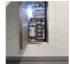
Elektroverteilung hinter Feuerschutz-Wandklappe T90.
