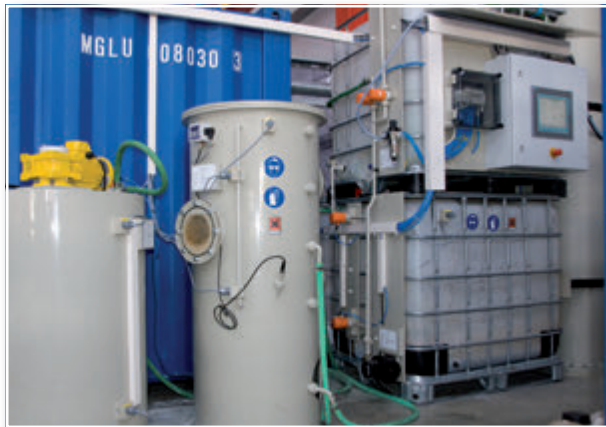
Aufbereitung von Abwasser zur Wiederverwendung in der Produktion
