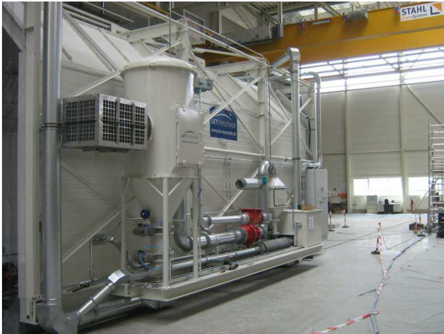
Filterzentrale mit gefahrloser Druckentlastung in den Arbeitsraum gemäß ATEX 100a und FSA-Cert. über ein IndoorVent
