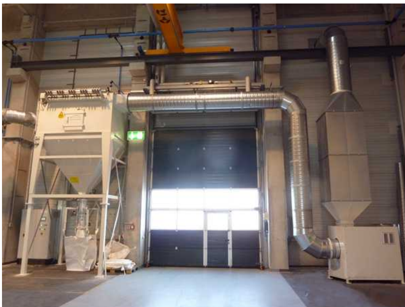
Schleifkabine mit explosionsgeschützter Absaug- und Filteranlage PFJ-15.000, druckentlastet über einen Berstkanal durch die Außenwand
